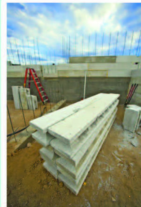
5.32 Actualmente existen muchos proyectos de reciclado de plástico para la fabricación de materiales de construcción.
